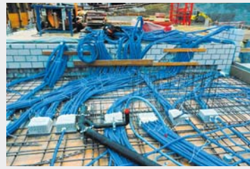
Hungerbühler Elektroanlagen GmbH, Kirchstrasse 4, Amriswil, www.elektro-hu.ch
