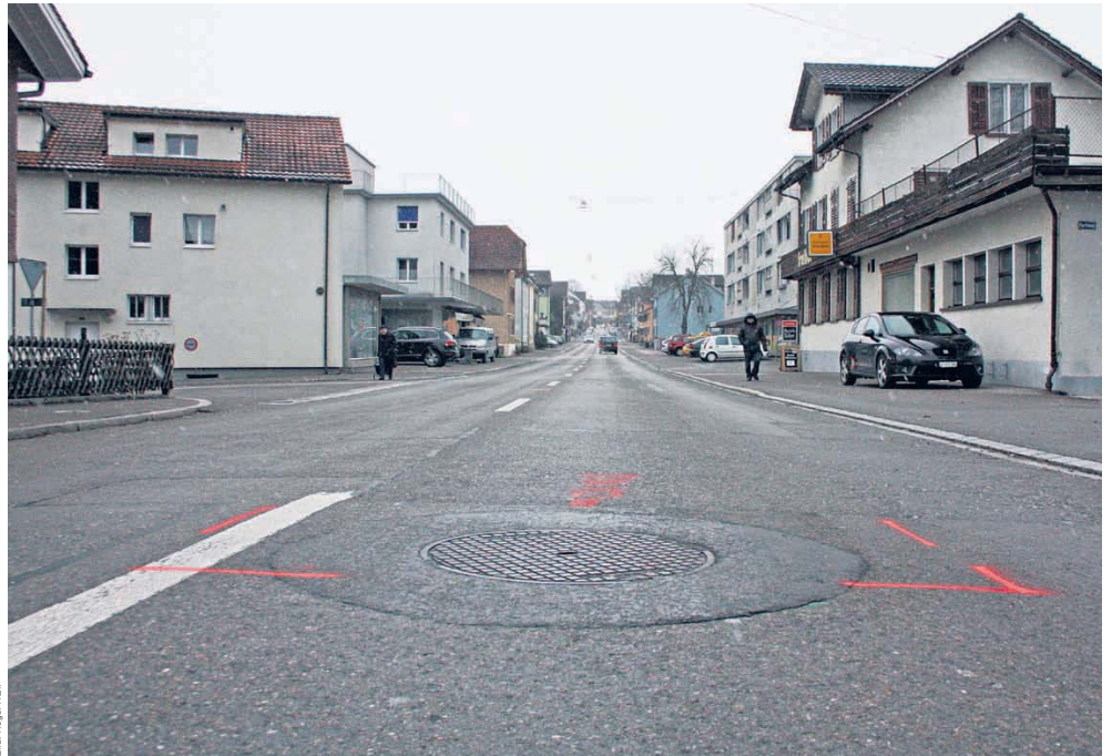
Sanierungsbedarf an der Unteren Bahnhofstrasse: Die Strasse selbst wird erneuert, wenn die Unterführung fertig ist.
