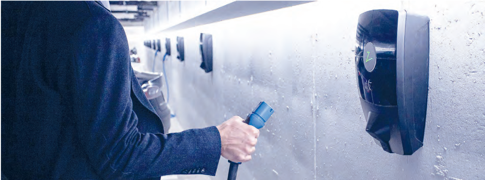
Besonders in Mehrfamilienhäusern können die Lademöglichkeiten für elektronische Autos früher oder später ein Thema werden.
